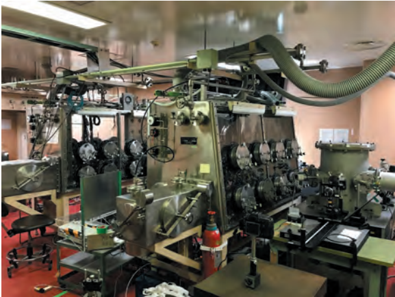
日本最大のトリチウム利用設備
